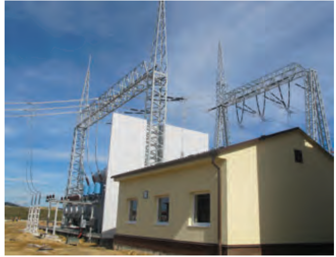
Jedna z budov v areálu transformovny
